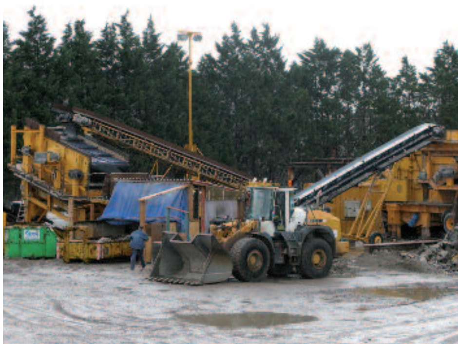
Deze brekerinstallatie van Sturm en Dekker werd na de pilot als eerste voorzien van het GPS + -systeem.
